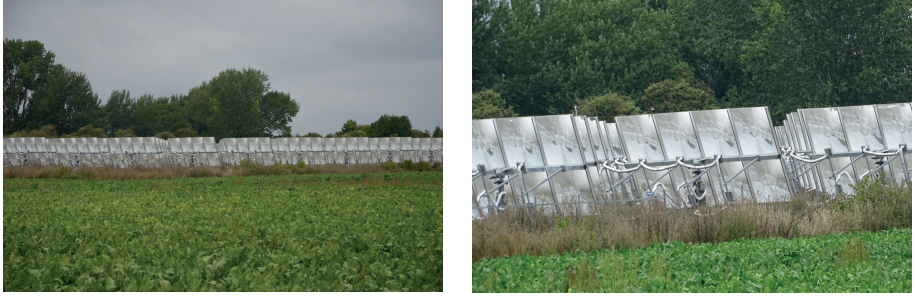
Abb. 4: Beispiel für eine Flächensolarthermieanlage in Lendemarke in Dänemark / Quelle: Petra Schneider
